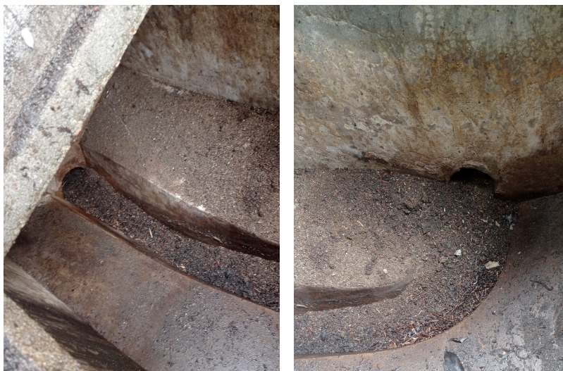
Fotos de cámara N°1. Se ve la presencia de tierra y no del agua vertida en la cámara N°2.
