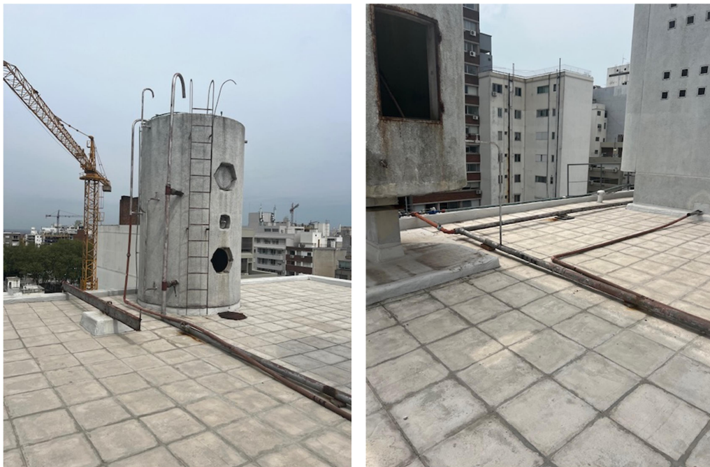
Salida de tanques en hierro fundido. Únicamente se utilizará la salida del tanque, el resto de la instalación deberá ser cambiada.
