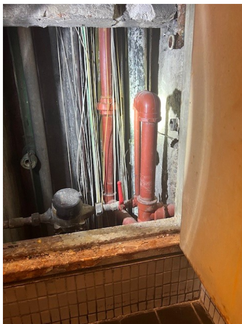
Fotos del estado actual de conservación de las cañerías a sustituir.
